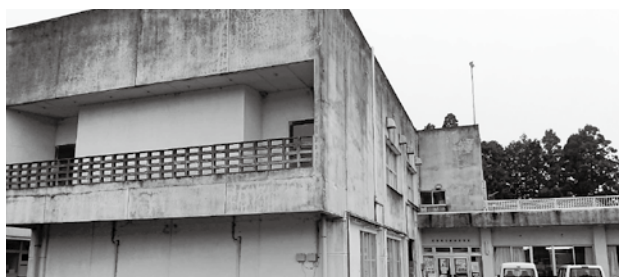
総合施設として改修が必要な公民館
