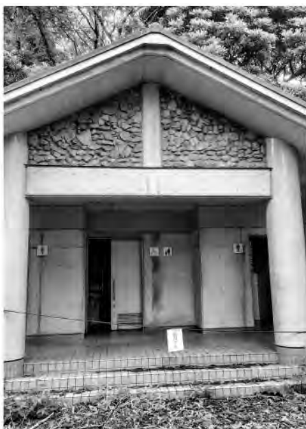
使用不能のトイレ
