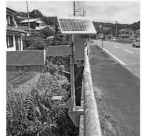
頭集に設置されている水位計
